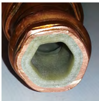
Kupferrohr mit Kalkschicht
